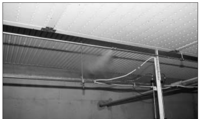
Bild 3: Wasserversprühanlage unterhalb der Zuluffführung im Stall
