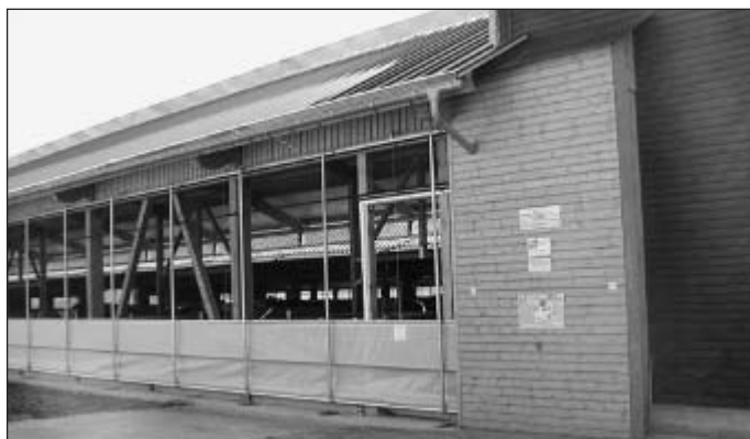
Bild 4: Zuluffführung über Außenwand mit aufwickelbaren Netzen
